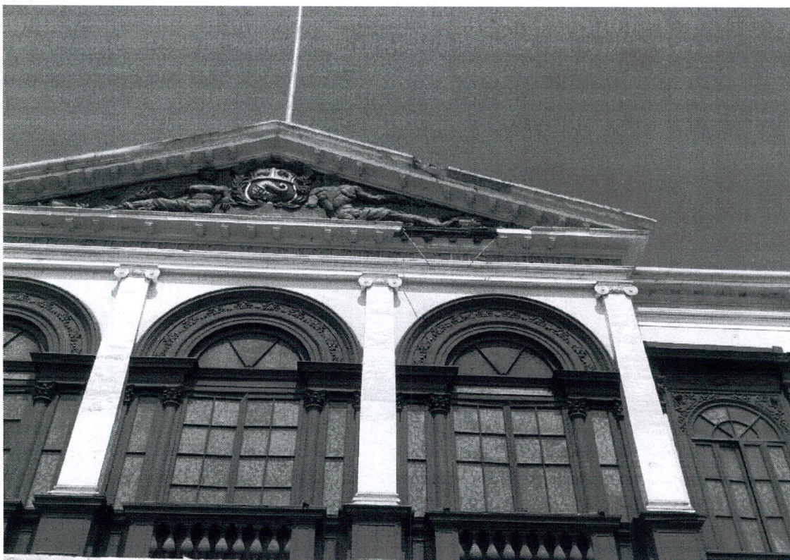
Figura1: Desprendimiento del frontis (IESTP. José Pardo)
